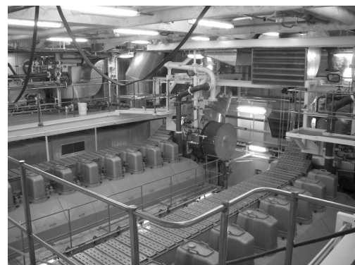
Abbildung 1: Maschinenraum eines Kreuzfahrtschiffes
